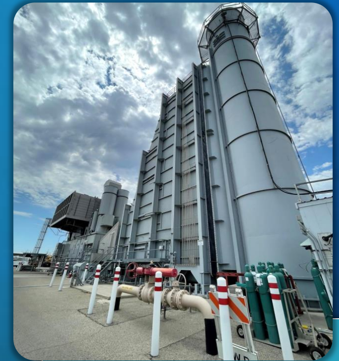
Combustión industrial Calderas/Calentadores de procesos/ Refinerías/EGU/etc.
