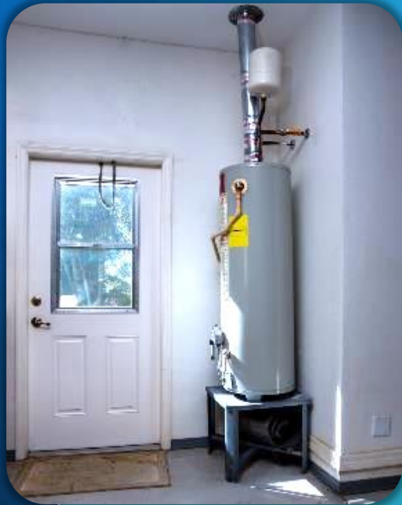
Combustión residencial Calentamiento de agua y espacios/ Cocinas/Otros
